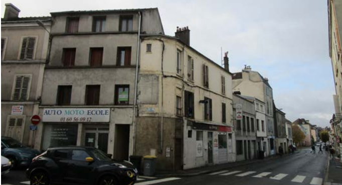
Façade dégradée à l'angle de la rue Saint-Liesne et la rue Bontemps
