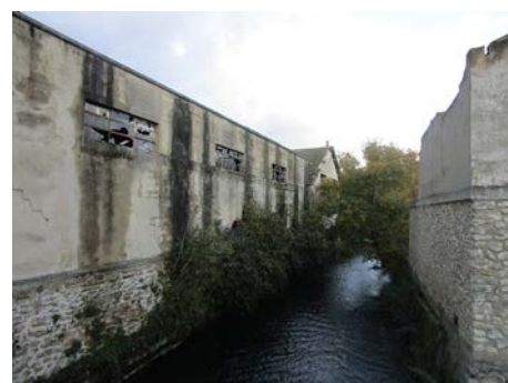
Absence de traitement des abords de l'Almont, rue des Fabriques
