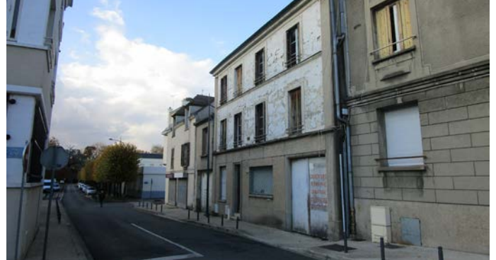
Façade dégradée rue du château, île Saint-Etienne
